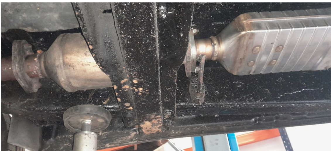
Katalysator monteret længere fremme på forrør, og DPF herefter. (Foto: Bilmageriet)
